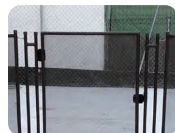
Πόρτα με αυτόματο κλείσιμο. Άνοιγμα πάντα προς τα έξω & να κλειδώνει πάντα προς την πισίνα. Automatic self closing gate. Opening always towards the outside & lock towards the pool.
